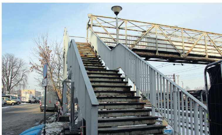
Kładka nad torami wymaga remontu
