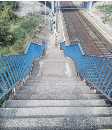
Przejście w poziomie torów zlikwidowano, zostały tylko strome schody
