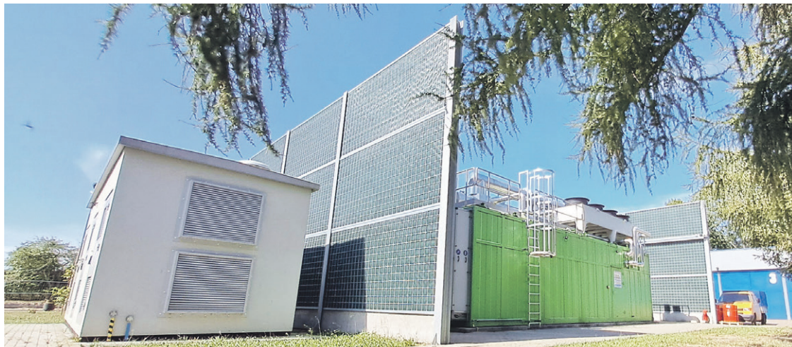
Agregaty kogeneracyjne na ul. Ciepłej
