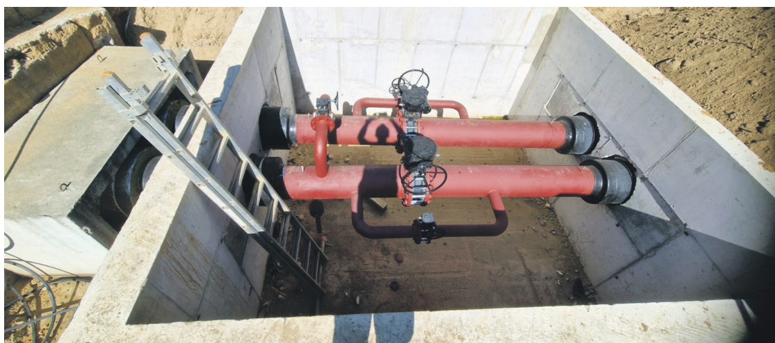
Komora ciepłownicza na ul. Krzywoustego
