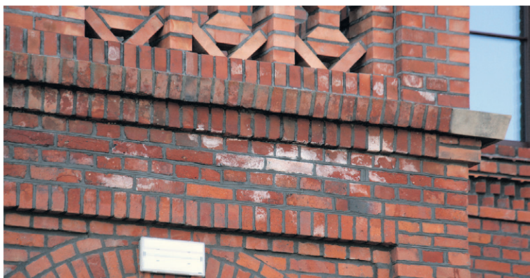
Wyszły zacieki i wykwyty
