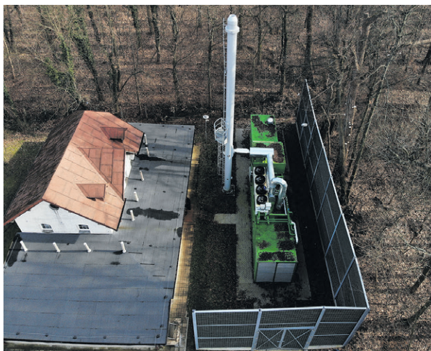
Agregat kogeneracyjny, ul. Brzozowa
