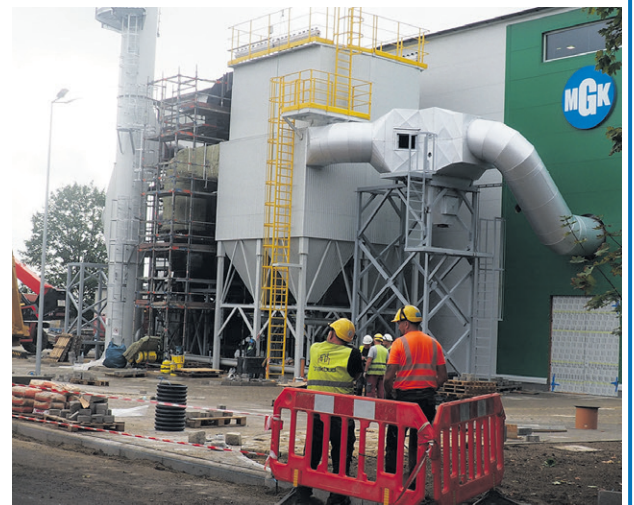
Widok ściany kotłowni na biomasę z systemem odpylania
