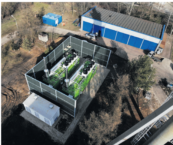
Agregaty kogeneracyjne, ul. Ciepła
