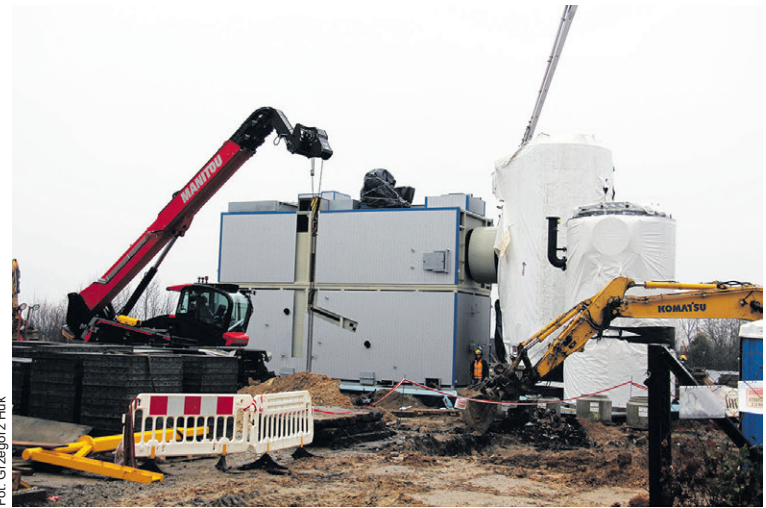
Pokryje 40% zapotrzebowania na ciepło
