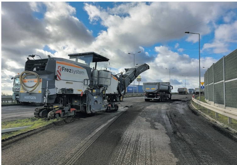
12 lat i już do remontu
